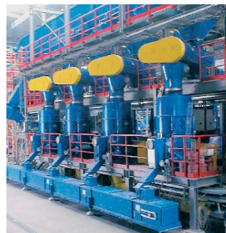
Установка вторичной переработки
