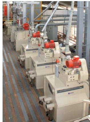
Шелушильные машины на рисозаводе в Перу
