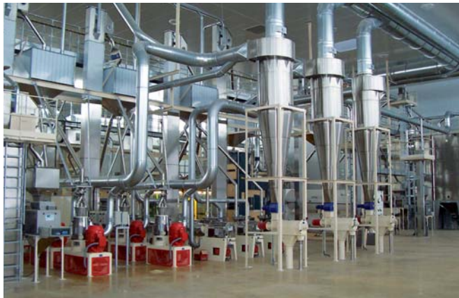
Установка гидротермической обработки в Испании
