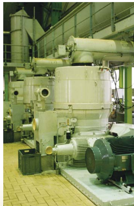
Современная станция фильтрпрессов на сахарном заводе
